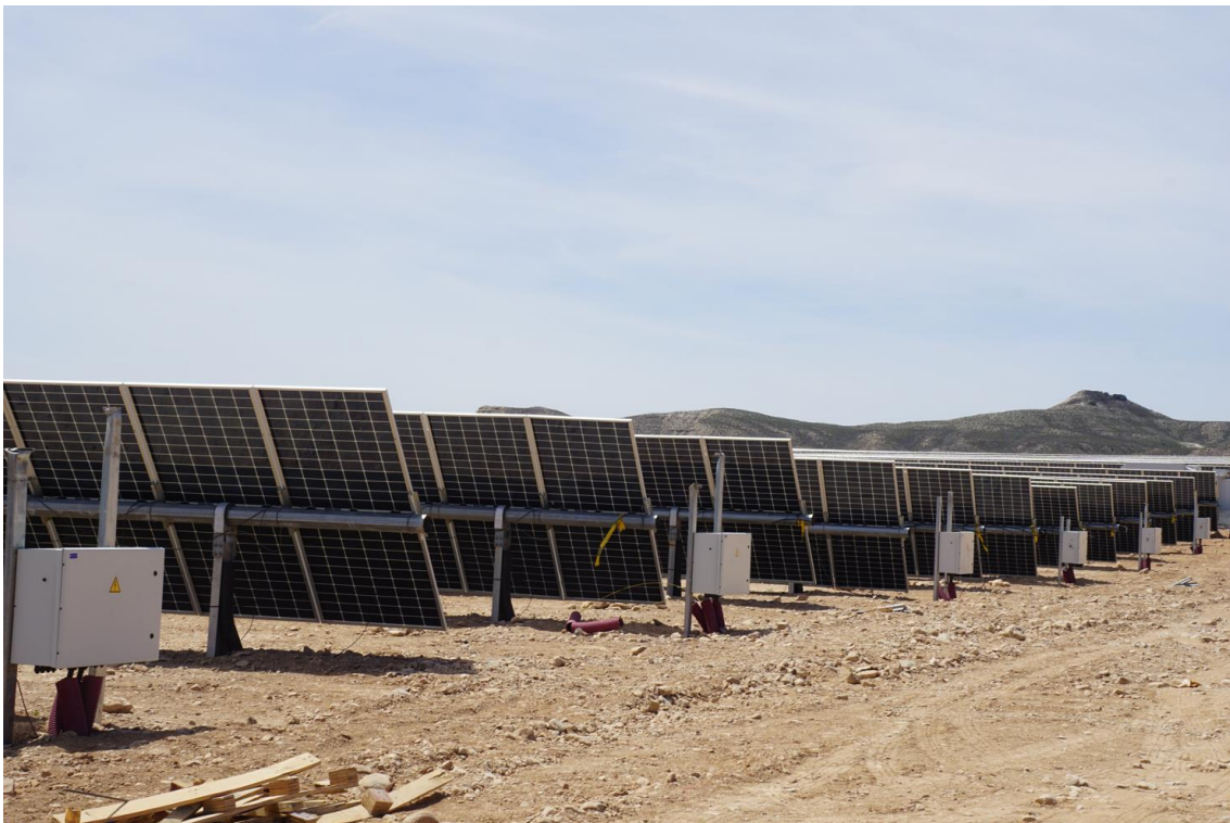
Figura 7 Cuadros eléctricos instalados
