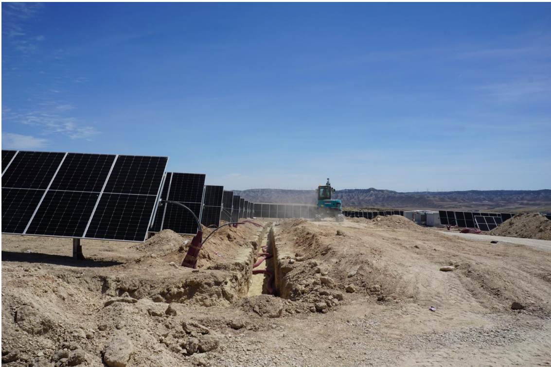
Figura 2a Excavación de zanjas en zona norte de Plana de la Pena 1
